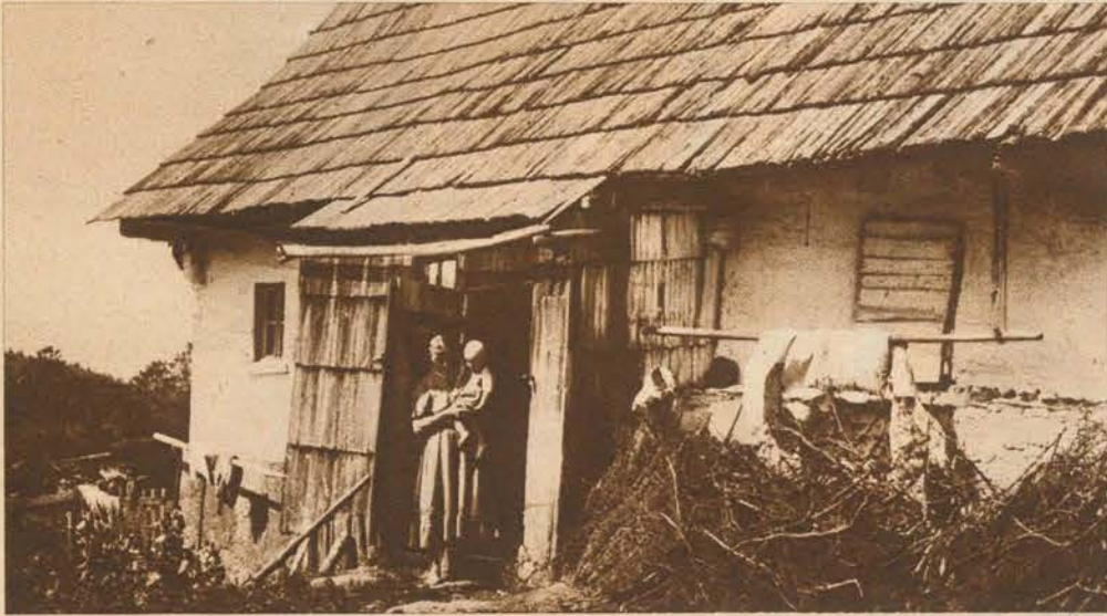
Eine alte Weberhütte, mit Schindeln gedeckt. Das Äußere dieser Katen ist im Gegensatz zu den Räumen hinter den Mauern noch als prunkvoll anzusprechen. Jeder Sturm reißt eine Tür oder ein Stück des Daches fort
